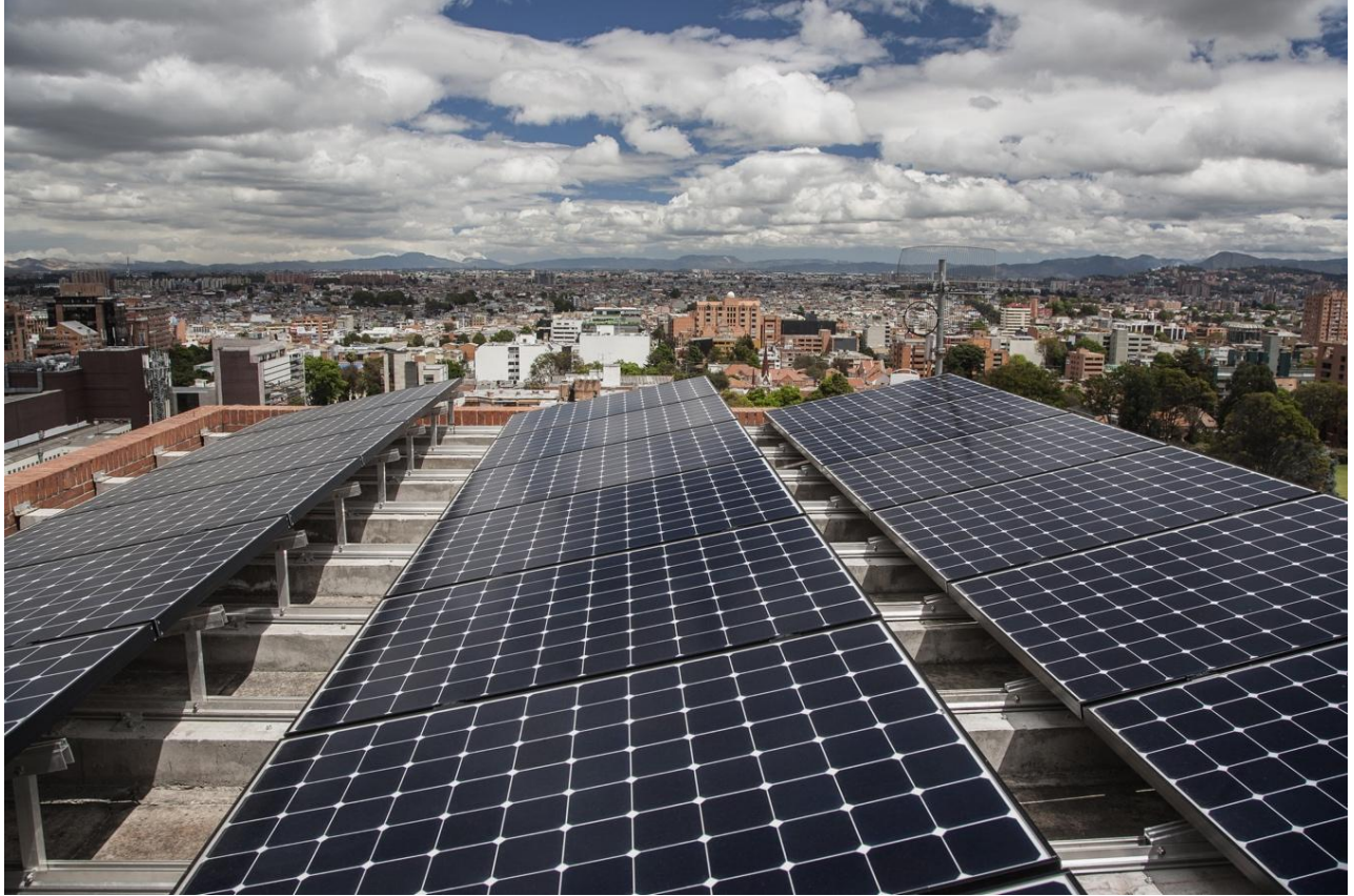
Bild 1 Photovoltaikanlage auf dem Dach eines Gebäudes in der Stadt Bogotá 3
